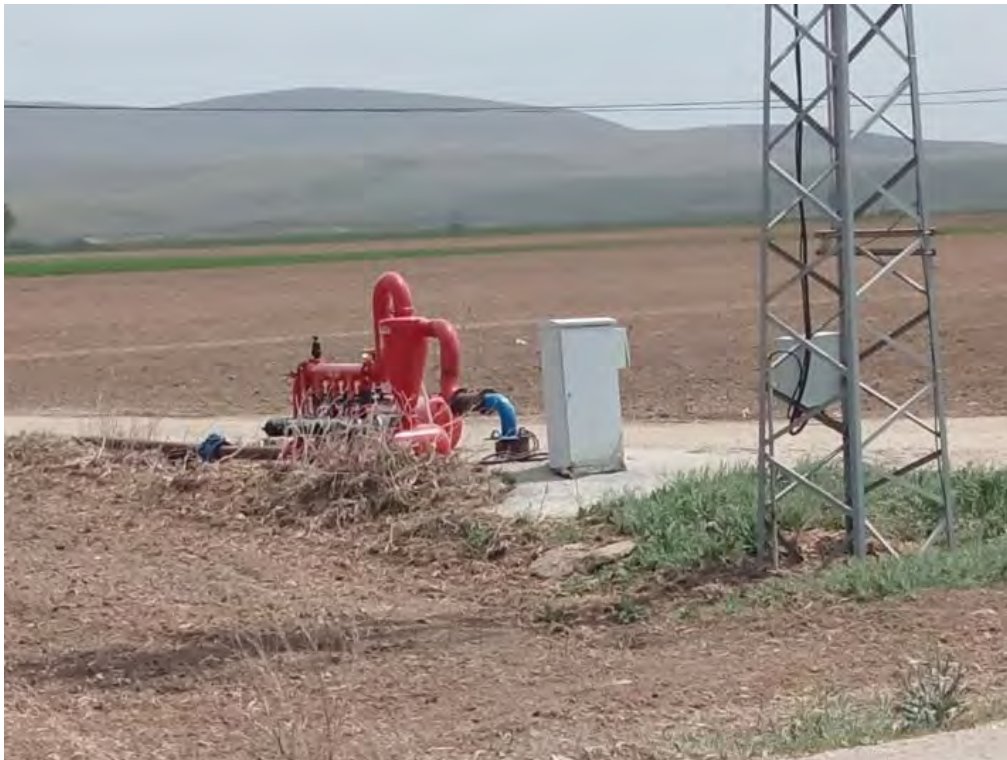
Grundwasserpumpe für die Bewässerung
